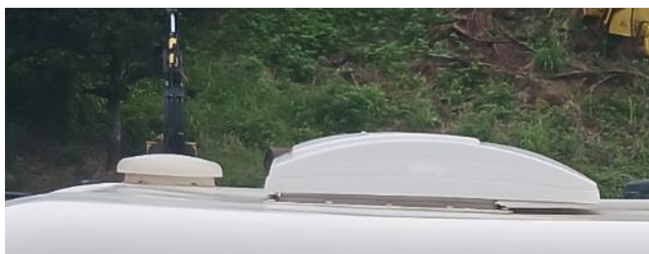
換気扇がフードが閉じた状態
